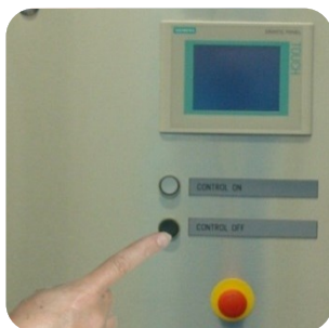
Drücken Sie am Schaltschrank die Taste „Steuerung Aus“
